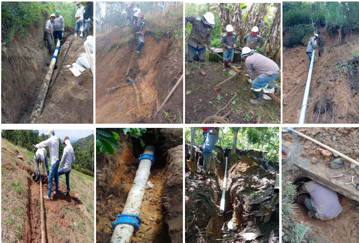
Daños y reparaciones acueductos rurales.
