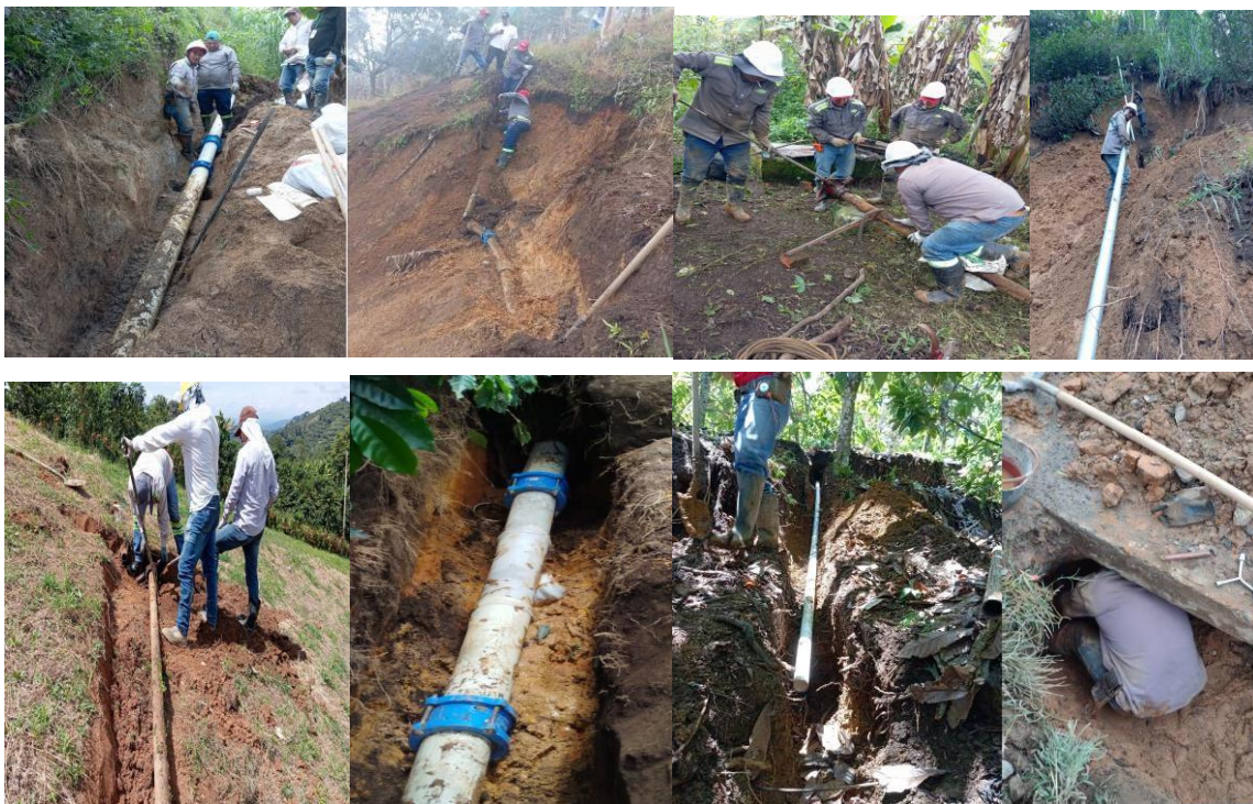
Daños y reparaciones acueductos rurales.
