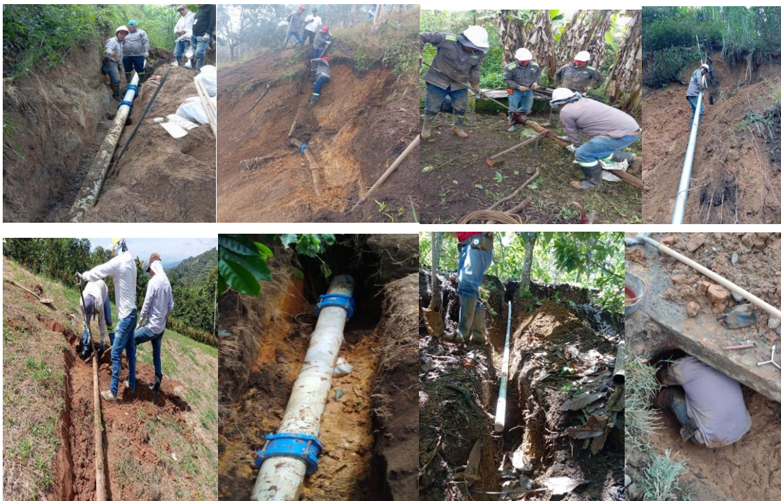
Daños y reparaciones acueductos rurales.
